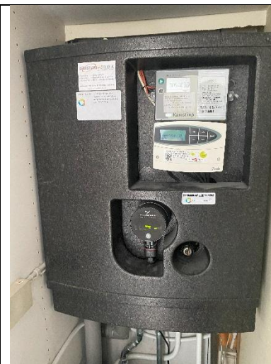
Fjernvarme og elinstallationer
