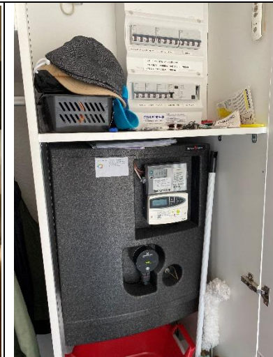
Fjernvarme og elinstallationer
