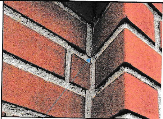
Revne ved mur, fuge repareres ved næste fugeudskiftning. (2.4.2)
