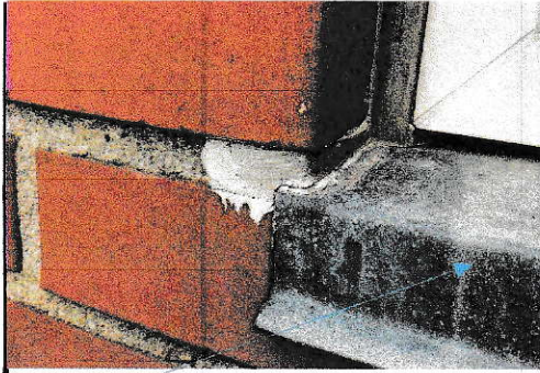
Zink sålbænk skiftes ved vindue/dør udskiftning.
