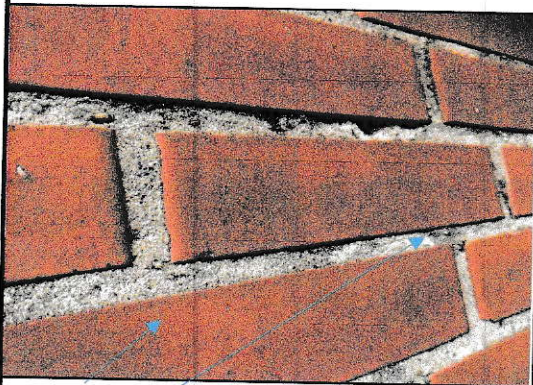
Forvitrede fuger skiftes ved næste fugeudskiftning (2.4.2)
