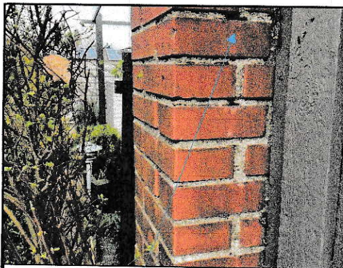
Fuger forvittrer ved læmur (13b) Skiftes ved næste fugeudskiftning (2.4.2)
